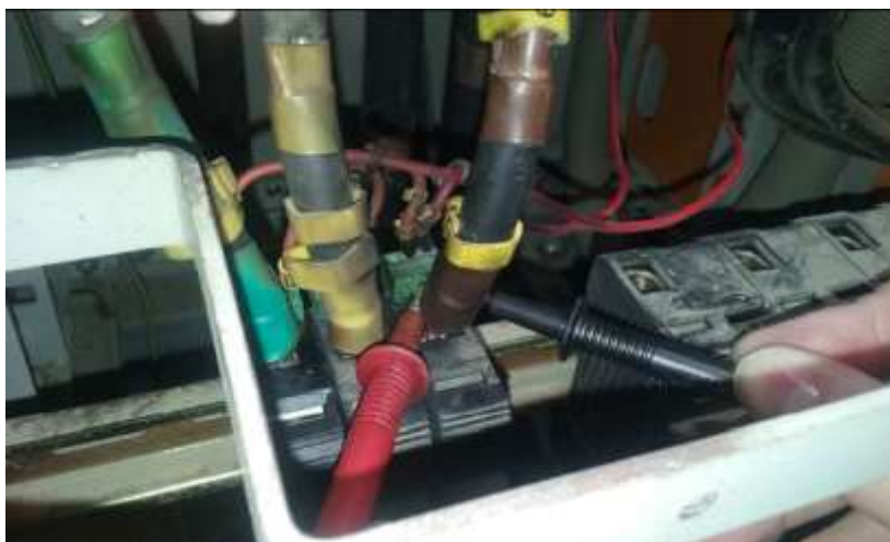
Zona en la que se produjo el cortocircuito. Situación simulada ¡SIN TENSIÓN!
